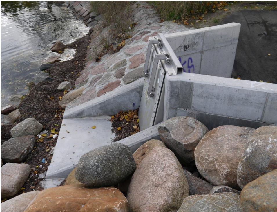
Figur 24. Exempel på slusslucka (Ramboll, 2020-11-05)
