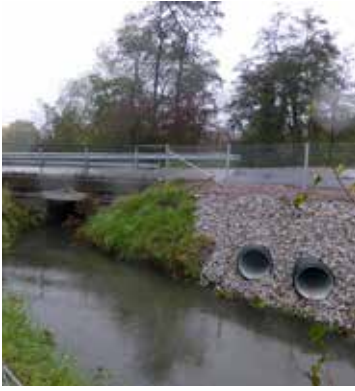
Bron vid Åkarpsdammen har tidigare varit en dämningsspunkt vid översvämningar.
