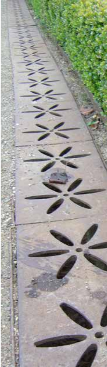
Dräneringsbrunnar eller acodrän kan se ut på många olika sätt.
